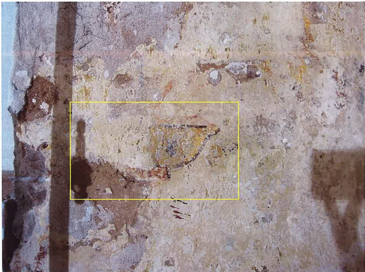
Reste der Barockfassung (1600/1700) um den vormals offenbar in das Mauerwerk kragenden Konsolstein herum.
